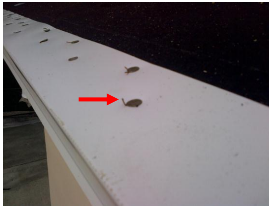
Residuo metálico en el borde de goteo.
